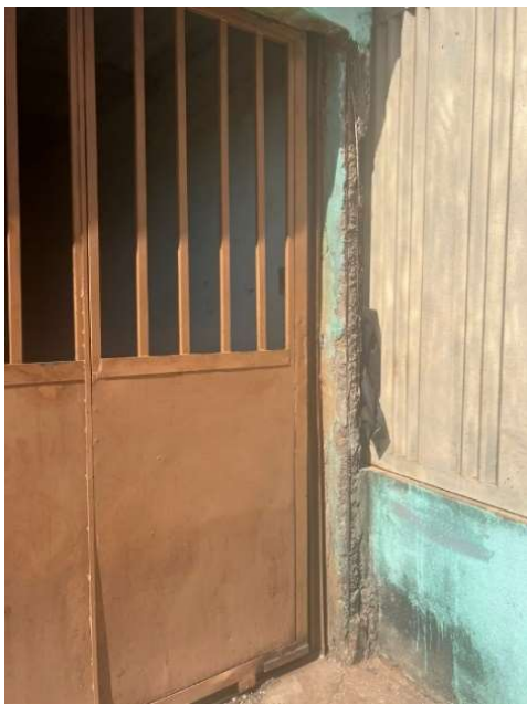
Figura 04 – Ferragens aparentes e danificadas.
