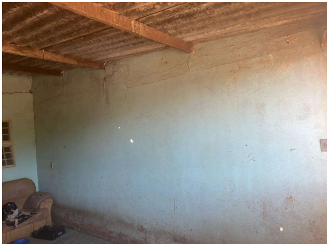
Figura 12 – parede com fissuras, infiltração próximo ao solo e pintura desgastada.
