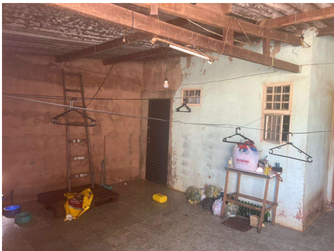
Figura 13 – parede sem acabamento, teto sem forro.
