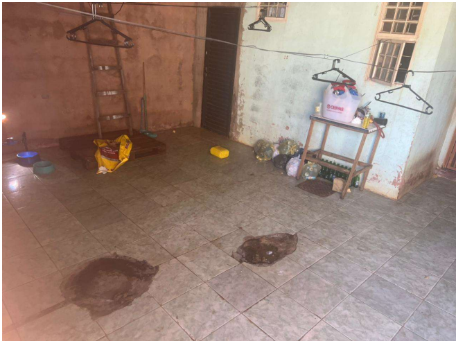
Figura 10 – Visão do interior do imóvel (destaque para o piso – cerâmica danificada).
