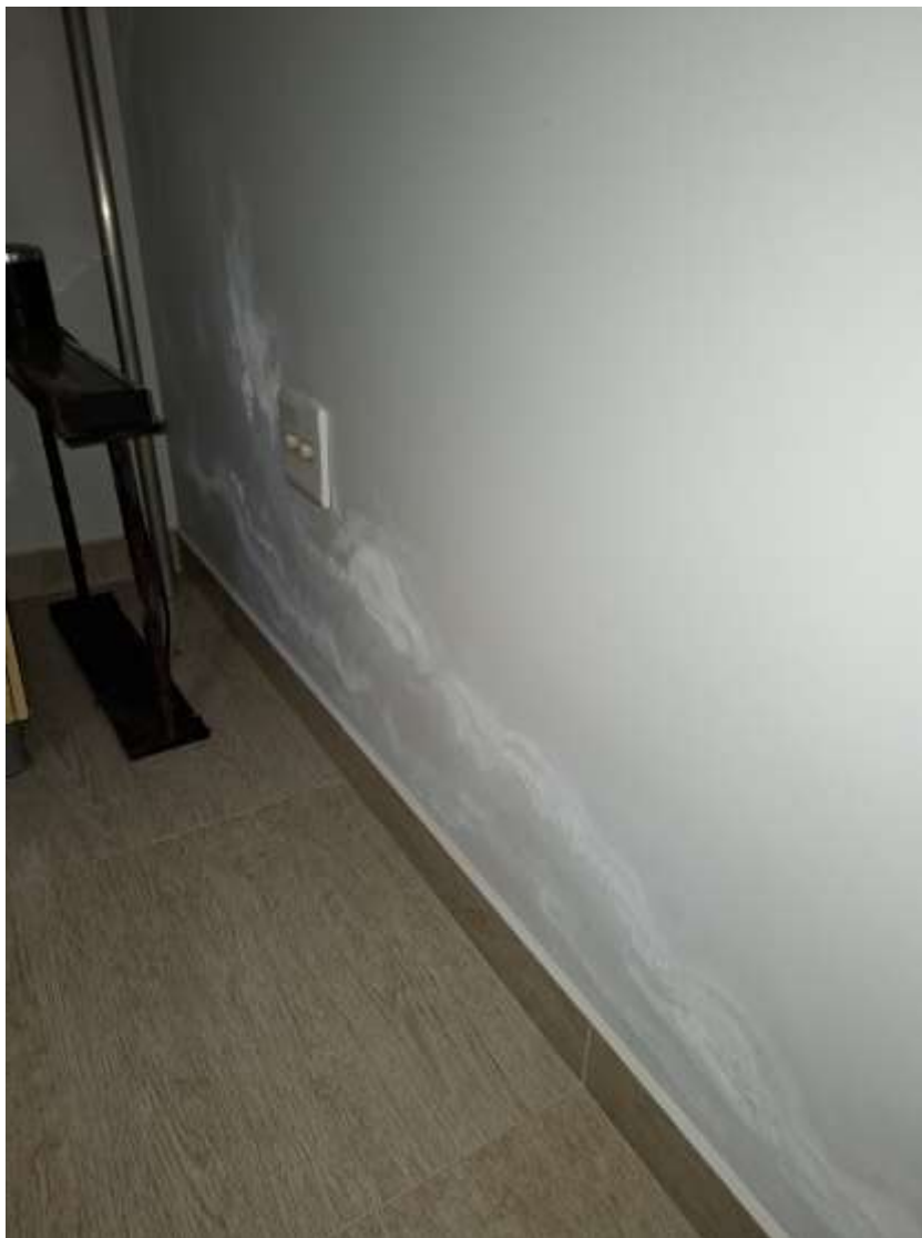
Foto N° 11: Mostrando a umidade próximo ao piso em um dos quartos, na parede de divisa com o imóvel confrontante.
