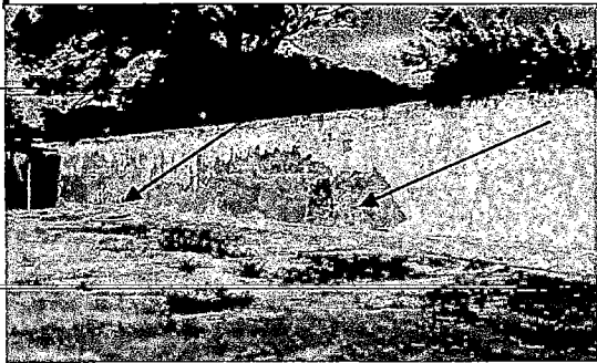
MURO DE CONTORNO REBOCO DETERIORADO
